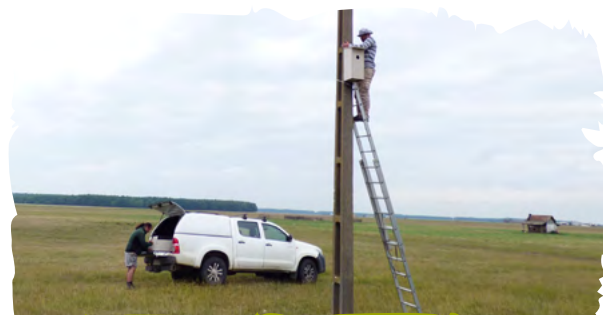
Stâlpii de medie tensiune izolați nu mai reprezintă un pericol de electrocutare pentru dumbrăveance sau alte păsări. Astfel, am putut amplasa și scorburile artificiale din betonită, care sunt folosite cu succes.
